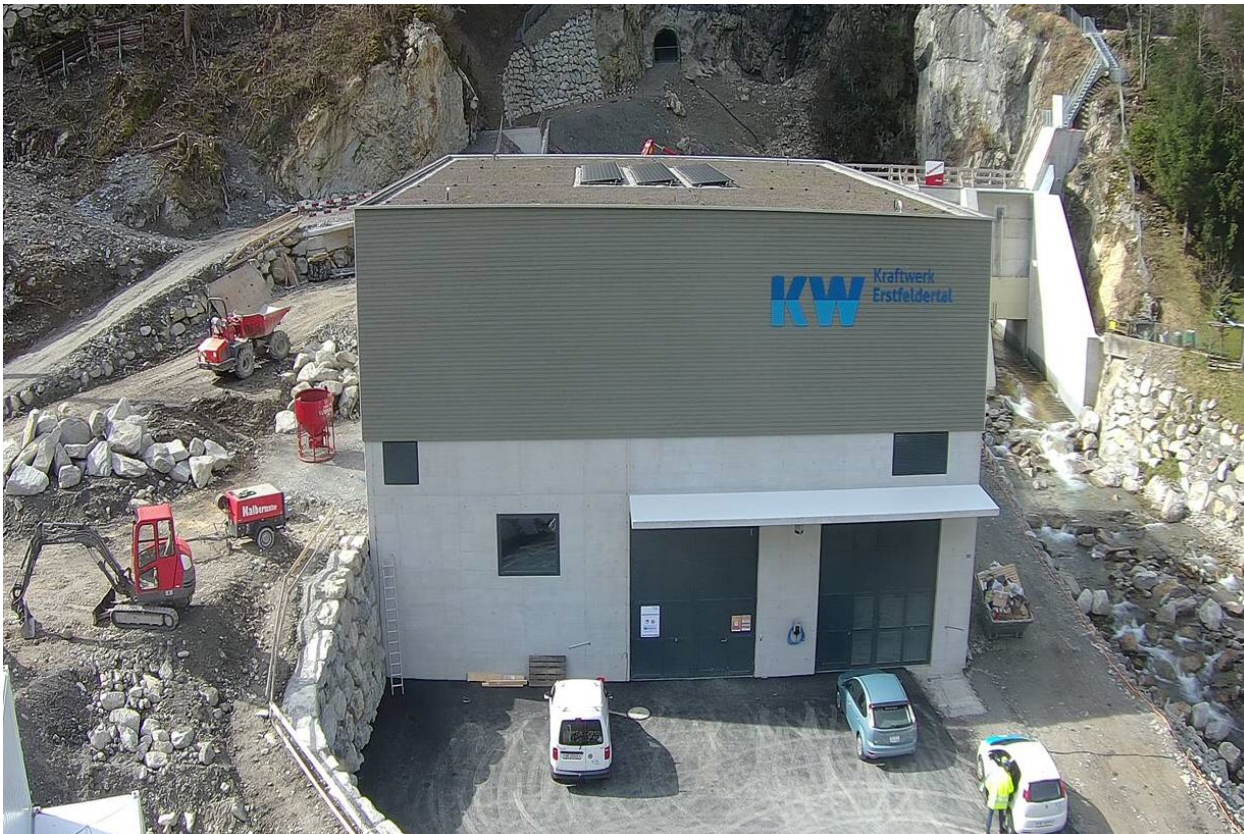
Die Zentrale des Kraftwerks Erstfeldertal
